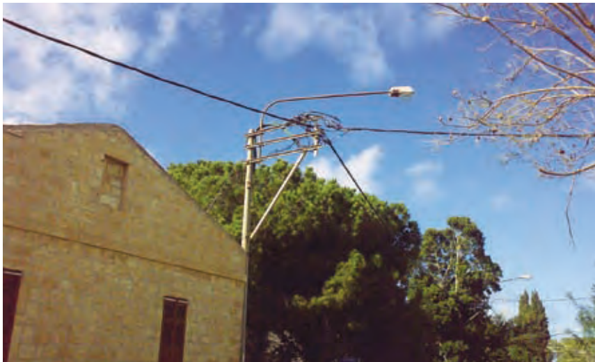
Afb.12 In vroegere tijden werden sommige kabels bovengronds aangelegd
