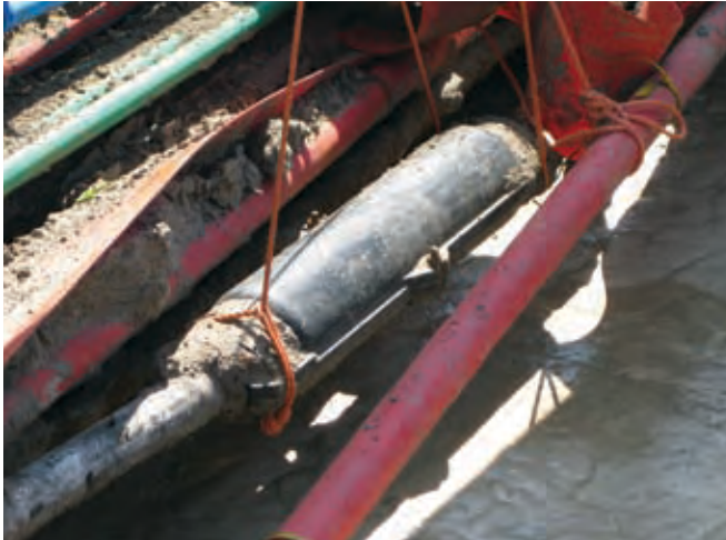
Afb.9 Mofverbinding in een electriciteitskabel
