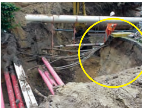
Afb.9 Voorbeeld van een ontgraving, waarbij het talud op instorten staat
