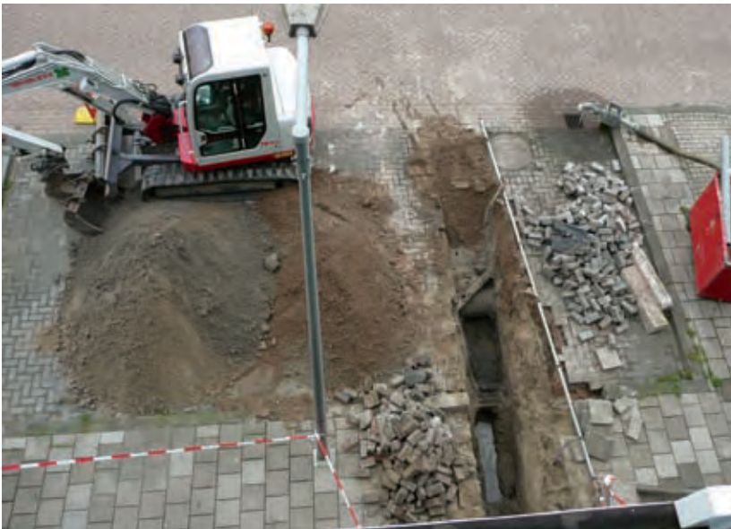
Afb.8 Bij het opsporen van het riool is door de minigraver de leiding stuk getrokken
