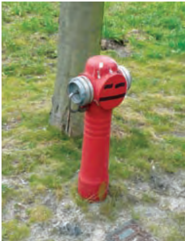
Afb.5 Hydrant: een bluswatervoorziening aan gesloten op de ondergrondse drinkwaterleiding.
