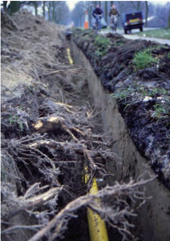
Afb.12 Boomwortels en kabels & leidingen
