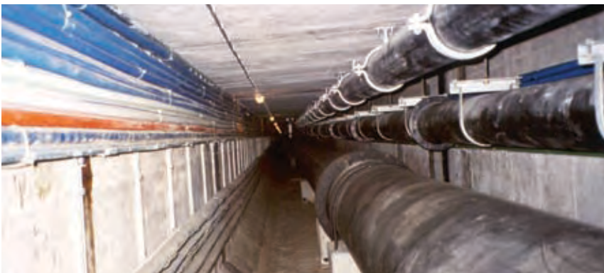
Afb.16 Hoofddrinkwaterleiding in de IJtunnel
