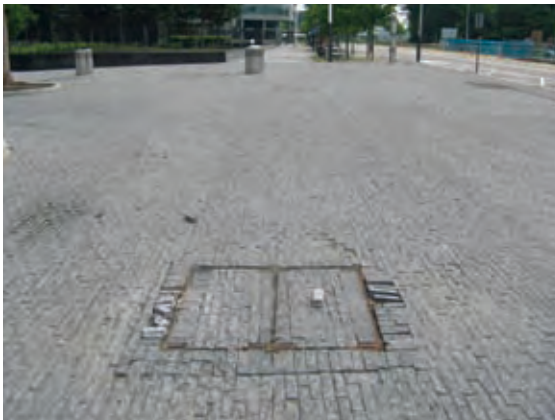
Afb.15 Schade aan hoogwaardig maaiveld door slechte inpassing van een putdeksel
