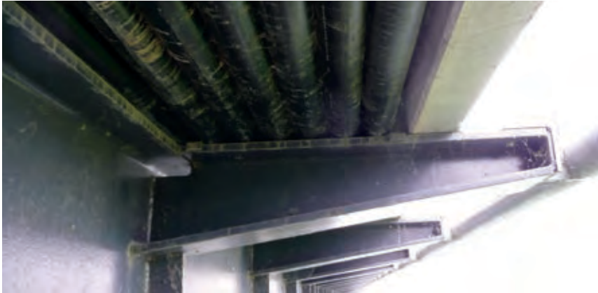
Afb.19 Voorziening mantelbuizen voor kabels onder een brug
