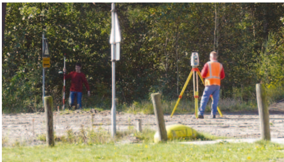
FIGUUR 13. Detectie van een kabel naast een bord waarop staat aangegeven waar de hoogspanningkabel gelegen is. Uit de rapportage valt niet op te maken dat deze aanwijzing is opgemerkt.
