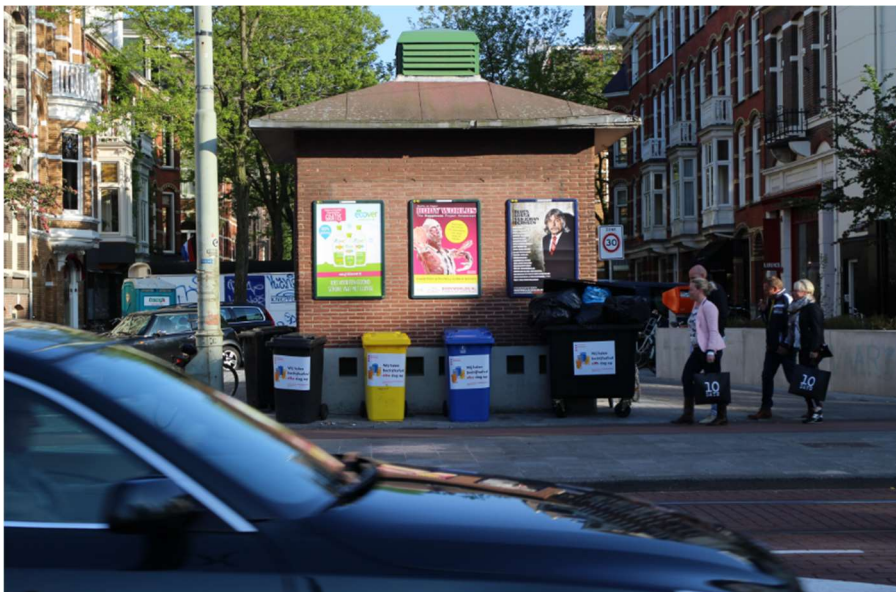
Figuur 1, transformatorhuis op kruispunt Willemsparkweg
