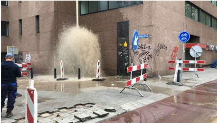
Figuur 6, gesprongen waterleiding
