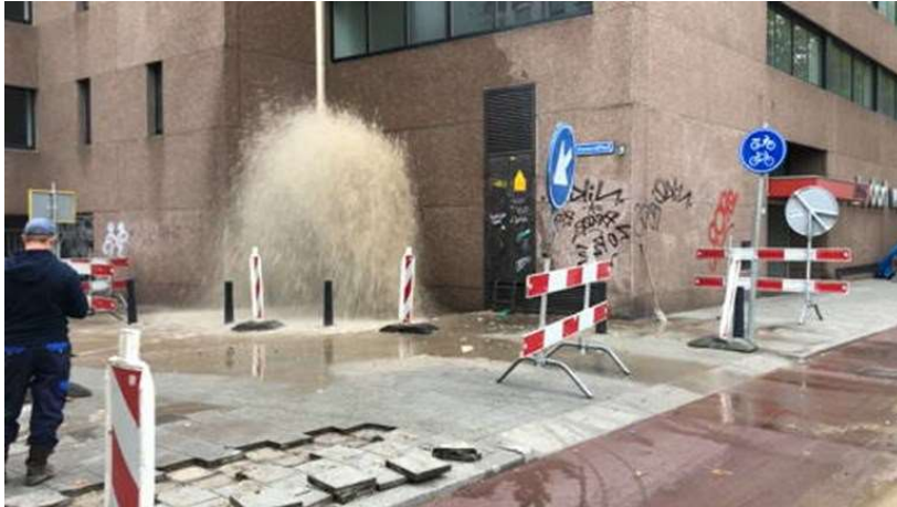
Figuur 17, gesprongen waterleiding
