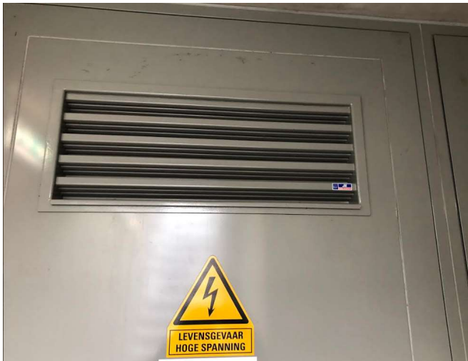
Figuur 10, ventilatierooster op deur
