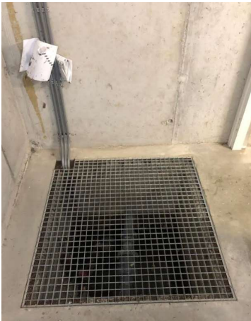
Figuur 13, pomp onder rooster op laag punt
