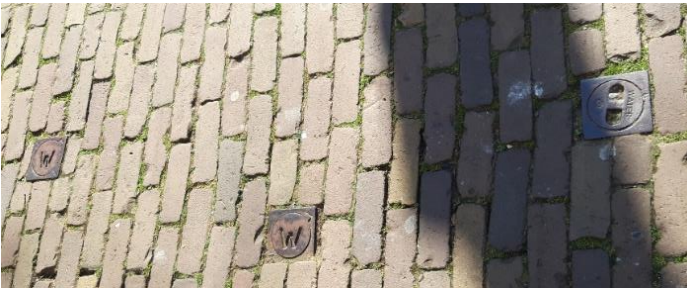
Figuur 24: Drie drinkwater afsluiters naast elkaar (bron: Eigen foto)
