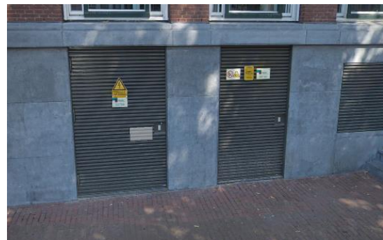
Figuur 32: Transformatorkast (Bron: GoogleMaps)
