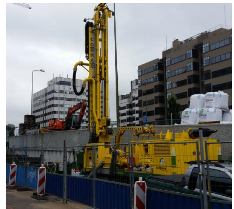
Figuur 62: Open WKO boorinstallatie (Bron: H.J. Lammers)
