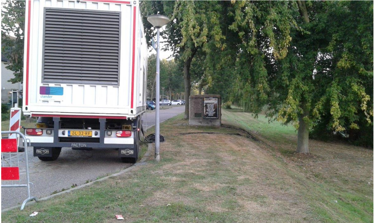
Figuur 35: Een noodstroom aggregaat die middels een kabel tijdelijk het laagspanningsnet achter het algemeen voedingspunt van stroom voorziet.
